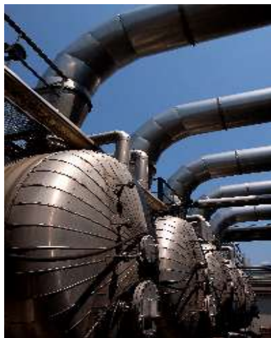
Impianto recupero solventi
